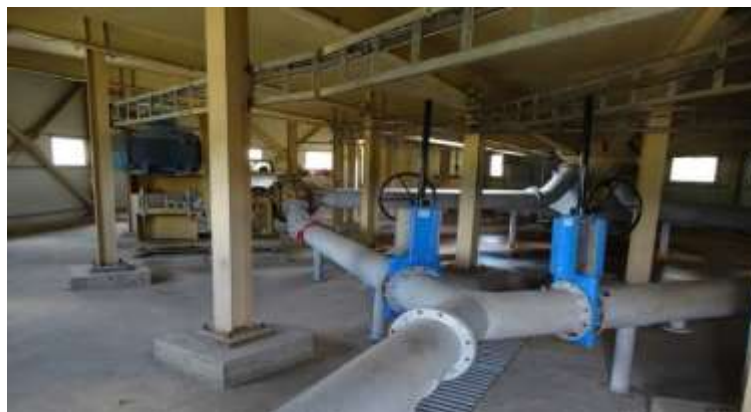
Водяные насосы и трубы в системе сгустителя
