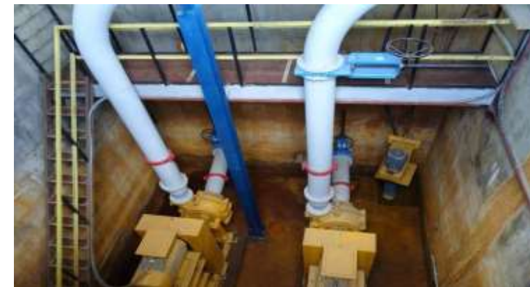
Яма шламовых насосов для перекачки в систему сгустителя
