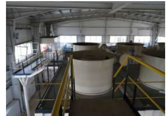
Резервуары завода по очистке воды
