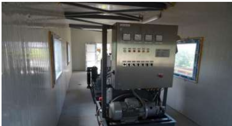
Электрический и гидравлический двигатель, управление сгустителем
