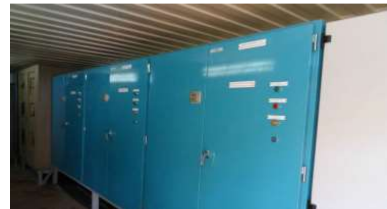
Электрическое управление и панели наблюдения
