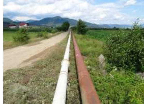
Шламовые и водопроводные трубы к дамбе Аурул
